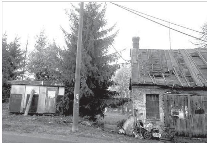
Značně zchátralá budova kovárny s propadlou střechou
