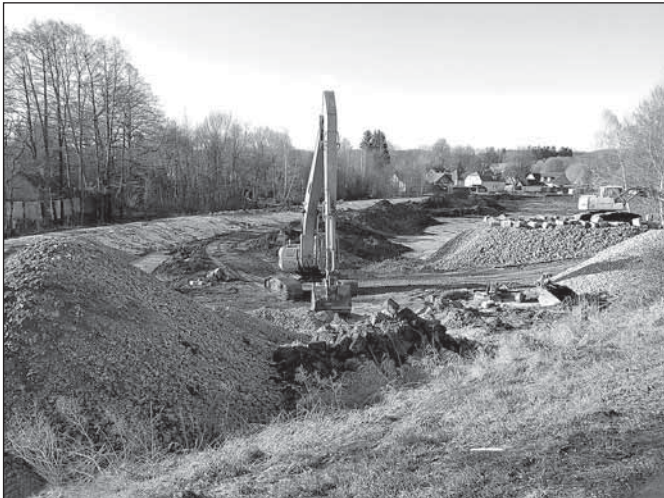
Retenční nádrž pod čerpací stanicí
