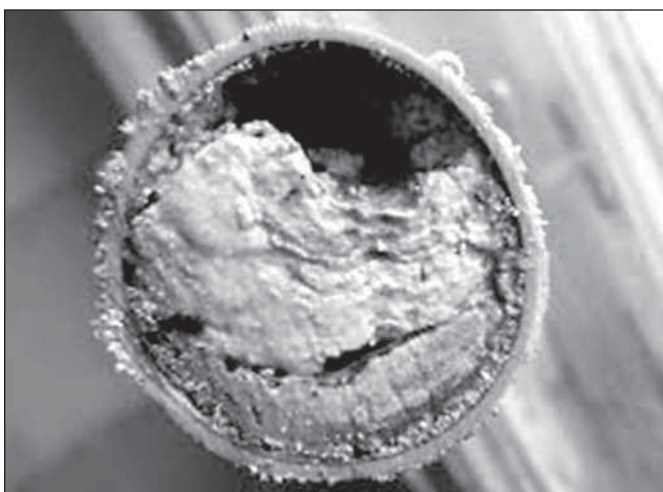
Odpadní potrubí ucpané tukem
