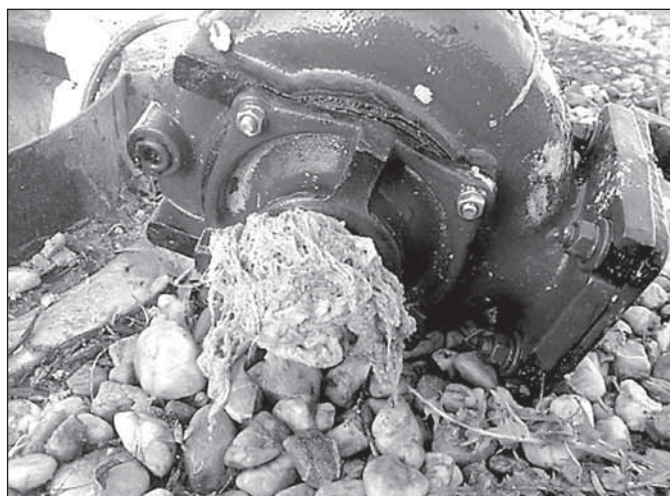
Kusy hader a zbytky vlhčených ubrousků v sání čerpadla
