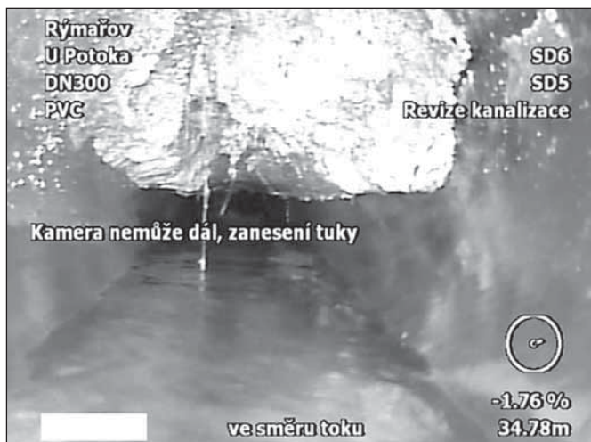
Kanalizační potrubí zanesené tuky
