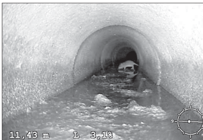
Snížený průtok kanalizace z většího bytového domu, v pozadí současný obyvatel (potkan)
