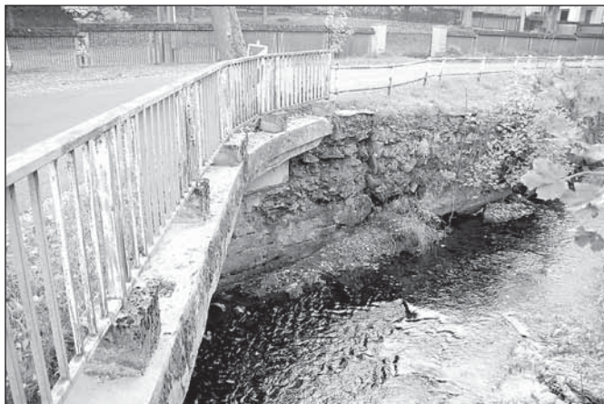
Nábřežní zeď je na více místech silně podemletá
