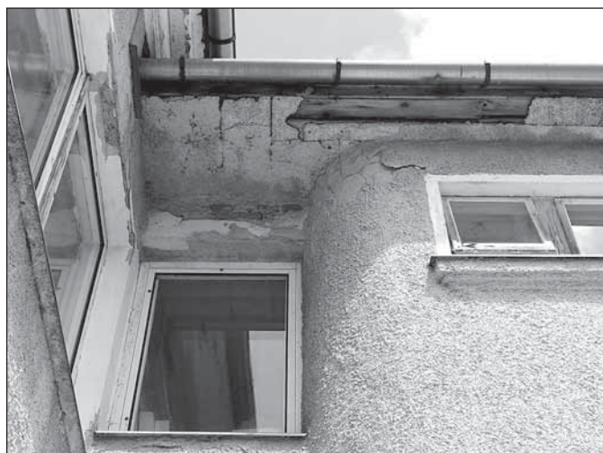
Mnohými místy střechy zatéká
