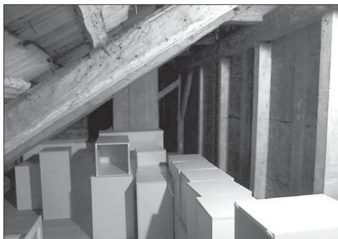
Střešní konstrukce napadena hmyzem; sbírky a výstavní mobiliář ohrožený extrémními výkyvy teplot a vlhkostí
