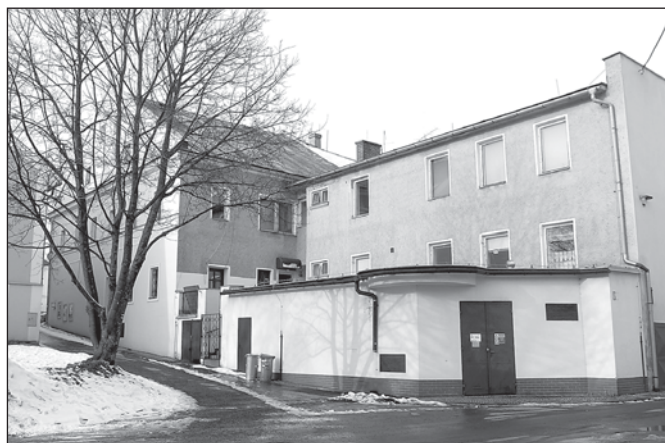
Celkový pohled na zadní stranu budovy s fasádou, okny a střechou v katastrofálním stavu, hyzdící frekventovanou cestu na náměstí
