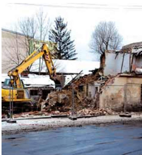
Neopravitelný a staticky narušený dům ustoupil novému parkovišti
