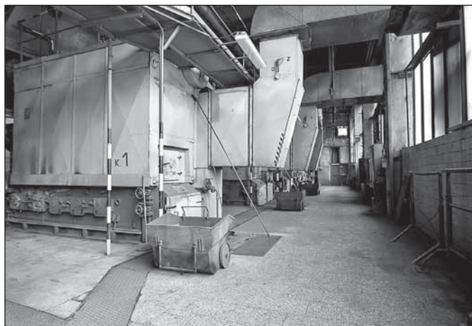
Původní kotle uhelné výtopny
