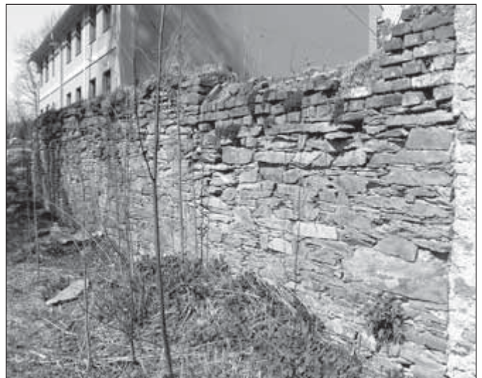
Zadní stěna zbořeného domku Zimových (20/42) navazuje na průběh hradební zdi
