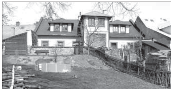
Zdivo tarasu a příčného křídla domku p. Štolfy (22/44), nelze vyloučit, že využívá zbytku hradební zdi, příp. hranolové bašty
