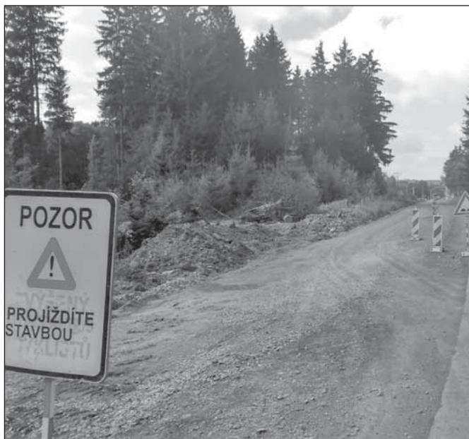
Tato část silnice vedoucí od Jamartic směrem do Rýmařova na svou opravu čeká
