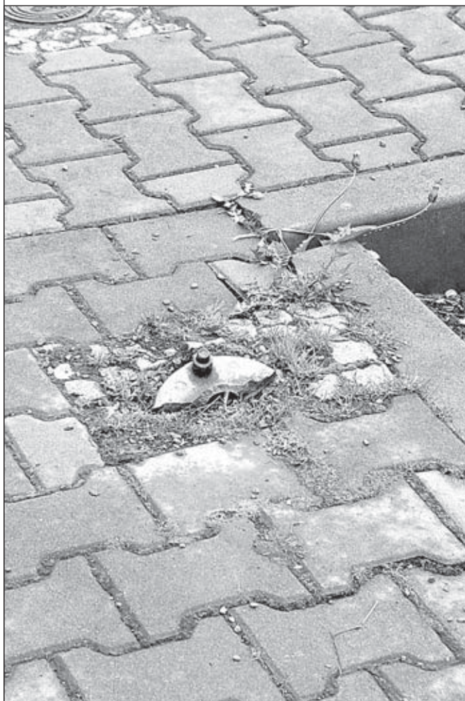
Torzo dopravní značky Parkoviště, nyní velmi vhodně umístěná nástraha pro chodce. Sídliště Příkopy
