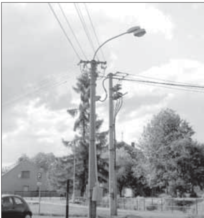
...až vzhledneš od hrbolů dlažby, nelekni se, sdrátovani nám nebesa... (Lokalita: křižovatka ulic Žižkova a U Potoka, poblíž mostu přes Podolský potok) Foto: Jiří Karel
