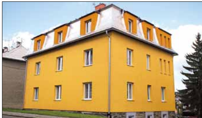
Rekonstrukce bytového domu na Bartákově 24 - v letech 2007 až 2008 vznikaly nové bytové jednotky (Národní 13, Hornoměstská 28, 30, 47, 49, 51, 57, 59), devět bytů vzniklo v rekonstruovaném domě na Bartákově ulici. Část nákladů projektu v celkové výši téměř 6 milionů Kč pokryla dotace Státního fondu rozvoje bydlení.
