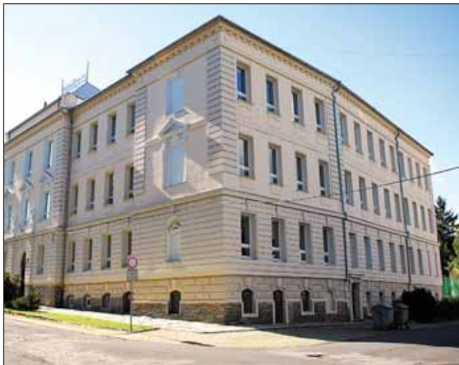
Oprava fasády a výměna oken na ZŠ Jelínkova 1 - zateplení historické školní budovy za 15,5 milionu Kč bylo dokončeno díky dotaci Operačního programu Životní prostředí v roce 2009.
