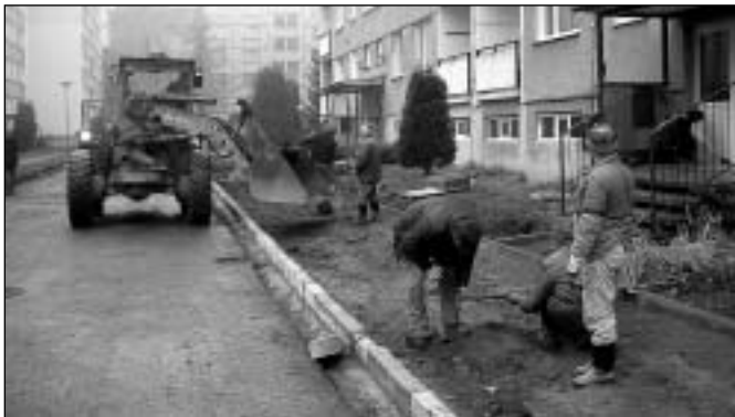
Městské služby jsou jednou z firem, které se v současné době podílí na revitalizaci sídliště Přtkopy v Rýmařově
